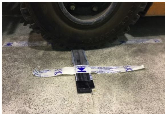
Capteur à fibre optique placé sur la chaussée entre deux lamelles de matériaux composites pour le pesage en marche
